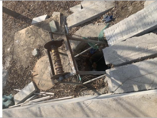
地下水监测井
