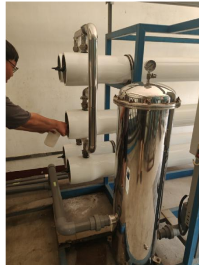
污水处理站出口
