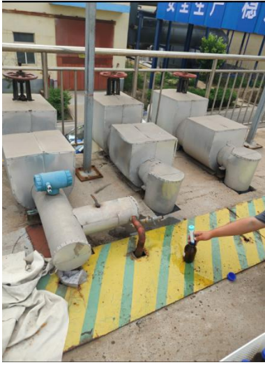
污水处理站进口
